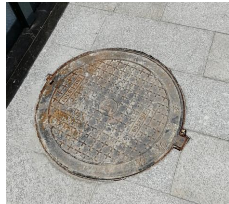
项目雨水排水设施
