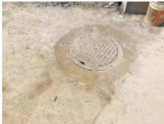
图 4-1 水土保持工程措施现状
