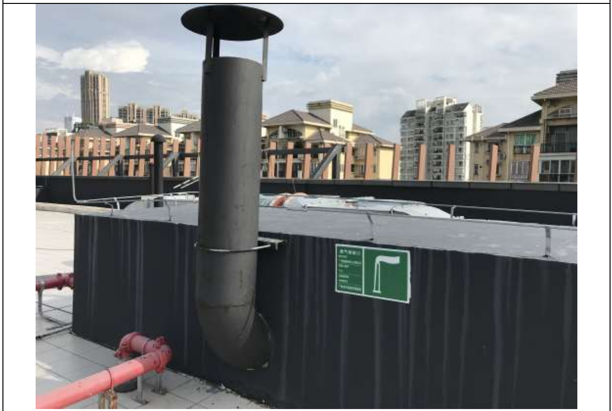
发电机尾气排放口：气-01（远照）
