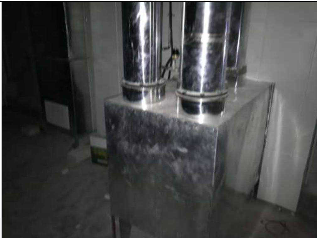
发电机水喷淋设施
