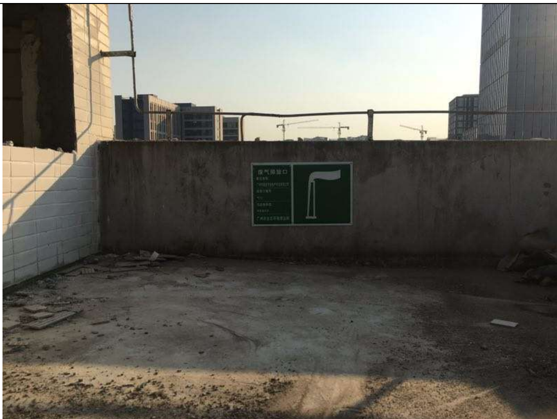
发电机尾气排放口：气-02（远照）
