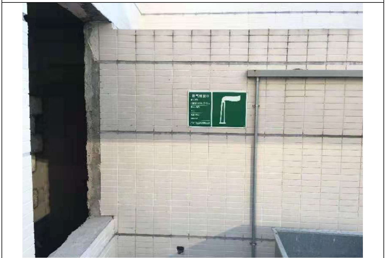
发电机尾气排放口：气-01（远照）
