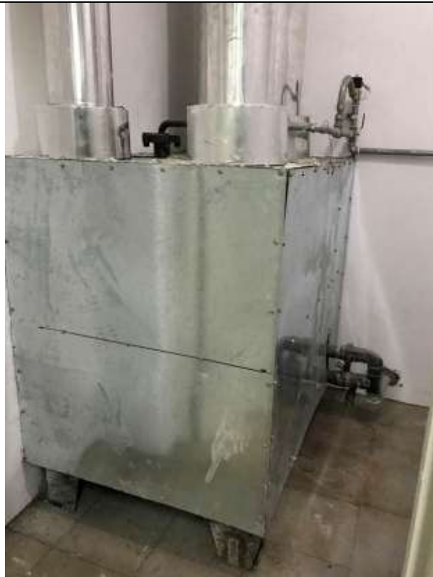
1号发电机水喷淋设施
