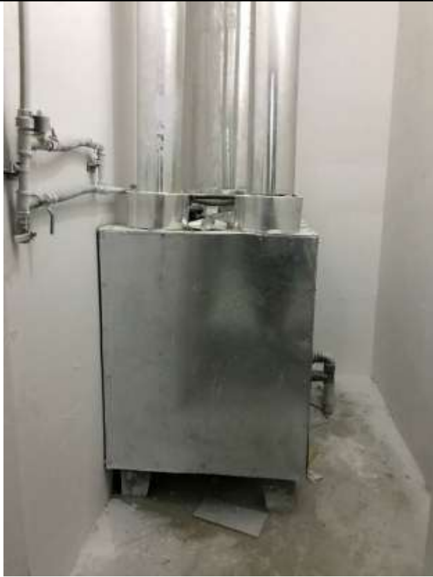
2号发电机水喷淋设施
