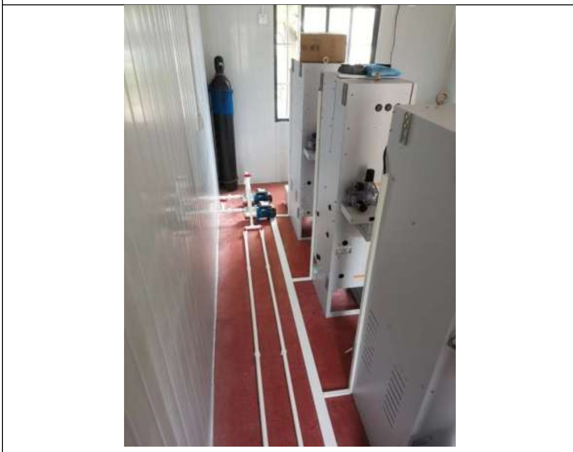
在线监测系统设备房内部
