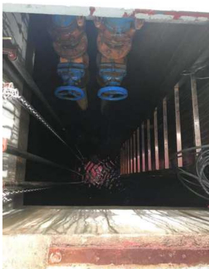
潜水泵所在水池
