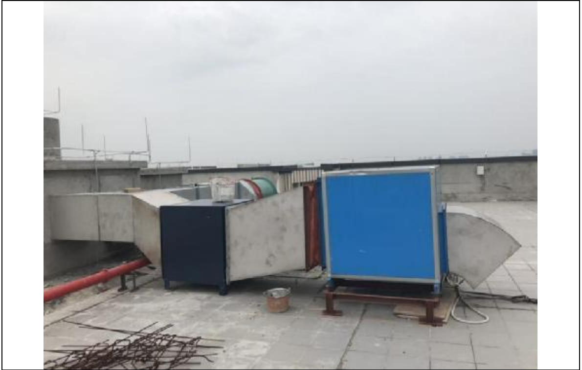
楼顶天面餐饮排烟口
